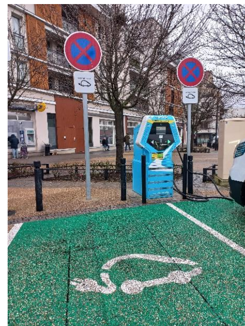
Borne de recharge pour véhicule électrique (IRVE)
