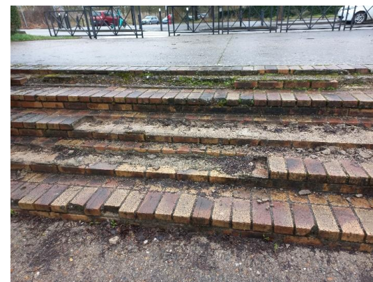
Un revêtement au sol abîmé
